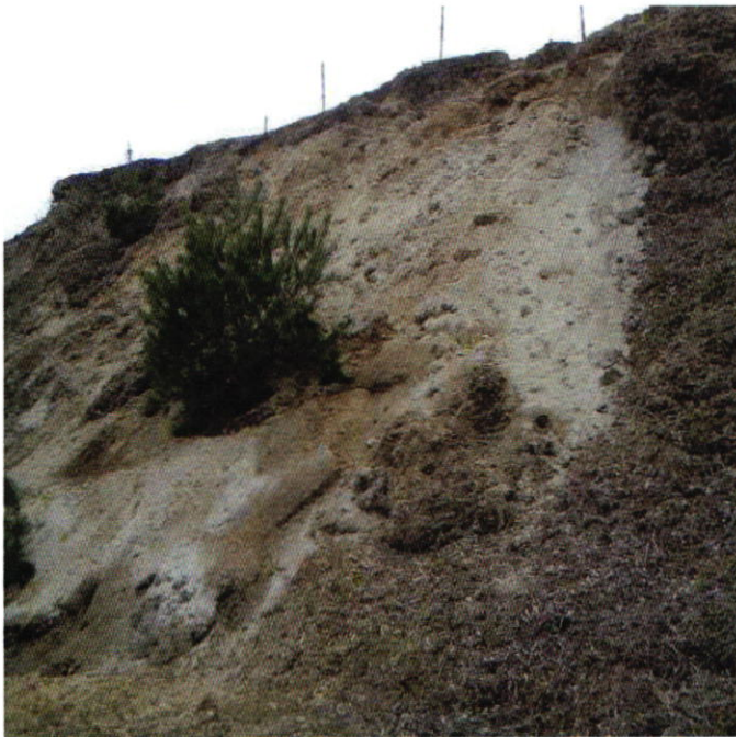
校地内の法面の崩落 2
