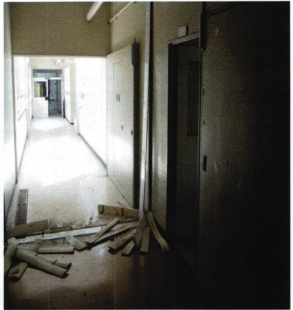
校舎内のエキスパンションの破損状況
