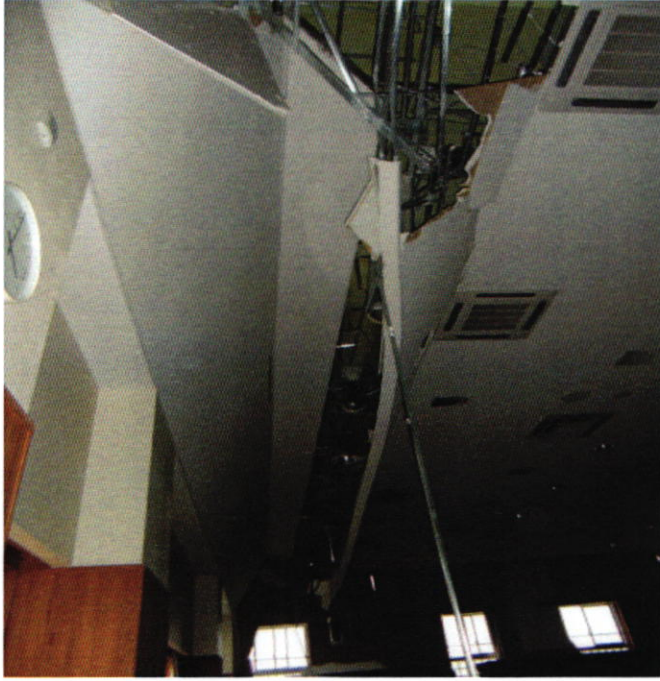
大講義室天井部分の落下
