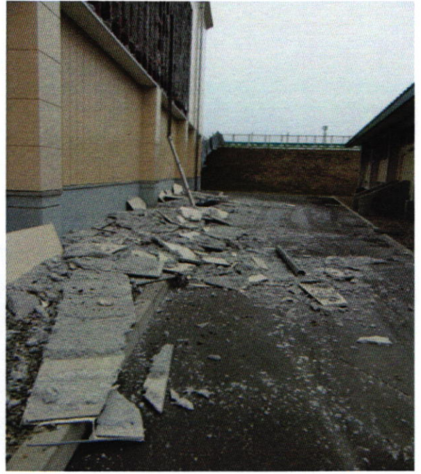
体育館東側壁面の崩落 2
