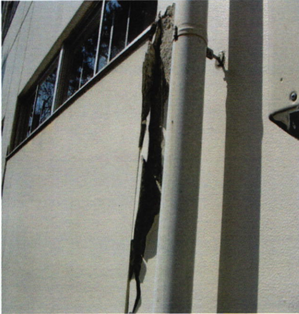
校舎外壁の損傷
